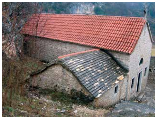
4 Pogled na crkvu i sakristiju prije obnove 2017. (foto: M. Zelić, fototeka KIM, 2016.)
